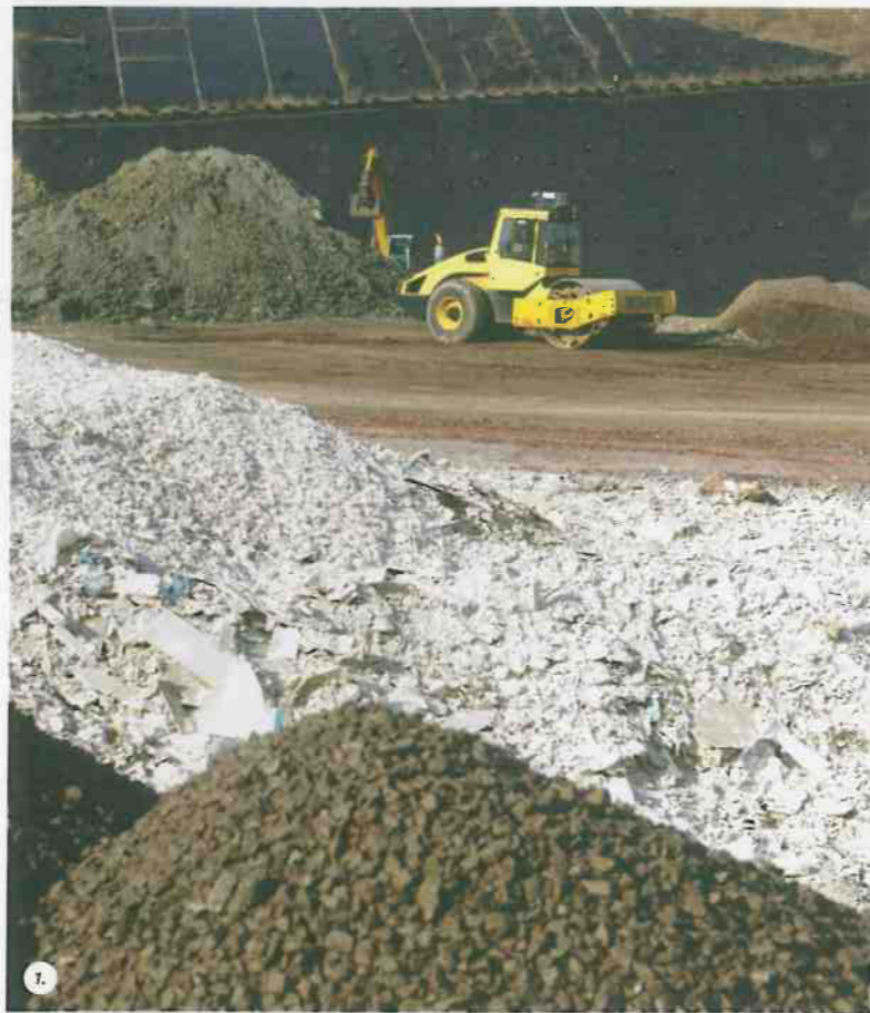
1. Einbaubereich Kesselparzelle, im Vordergrund Gips und Gleisschotter, im Hintergrund eine temporäre Oberflächenabdichtung 2. ständige Überwachung der Sickerwasservorbehandlungsanlage 3. Vorbereitung einer neuen Einbaufäche für Monofractionen wie z.B. gipshaltige Abfälle
